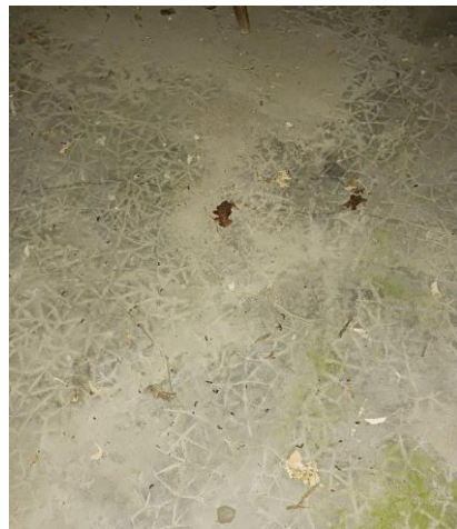
Photo 9 : Photos du bâtiment et guano
