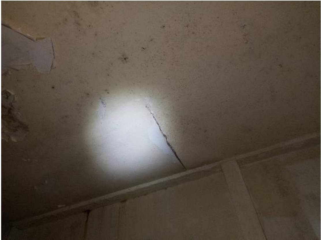
Photo 10: Fissure au plafond
